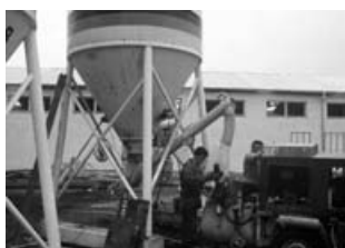
2.30 Kompletts berendezés – szállítósiló + EDS adagoló + Esztrichboy
