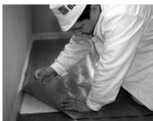
2.20 Az esztrich fólia helytelen elhelyezése a peremszigetelő sáv fóliája fölé
